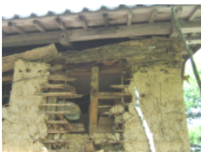
雨漏りの放置による土壁の劣化、下地の腐朽が被害を拡大した例 *
